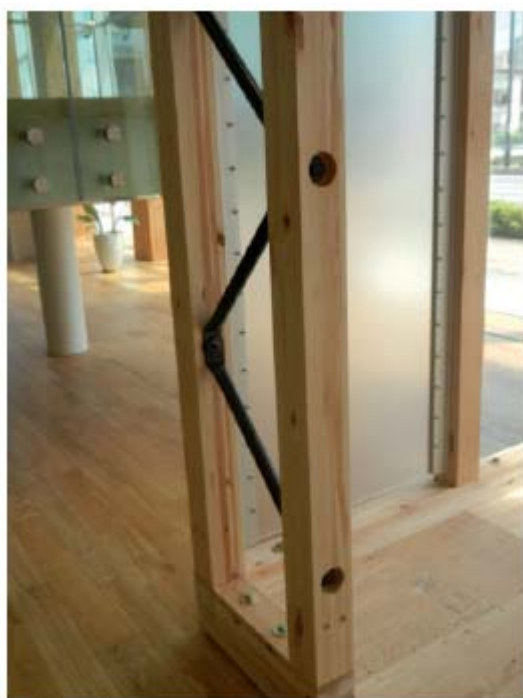
写真28-金属製トラスにより狭い窓間壁に設けられた補強柱間帯
