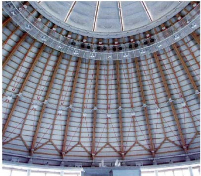
写真 3—2002 年に建設されたコミュニティセンターにおける、木材の梁および鋼材ロッドからなる複合構造
