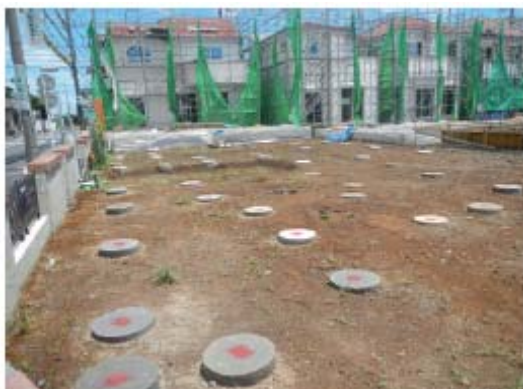
写真 36-基礎部分/床下空間上の鉄筋コンクリート製最下床の設置
